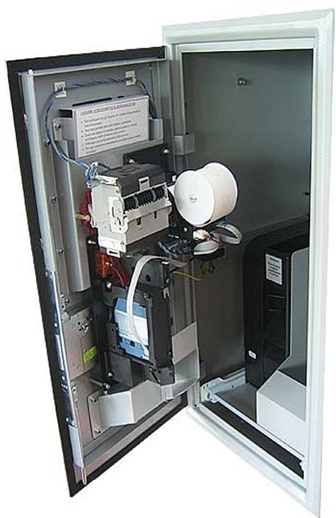
Detall interior màquina
